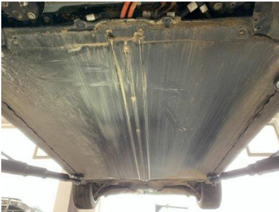
Bild 3: Beispiel für zu reparierenden Lackschaden an HV Batterie
